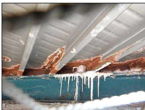
床版に腐食が見られます
