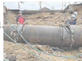
送水管の被害(七尾市)
