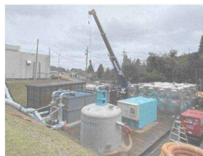
可搬式浄水施設・設備 (珠洲市宝立浄水場)
