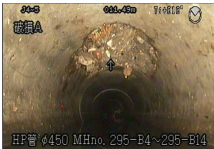
破損した下水道管路
