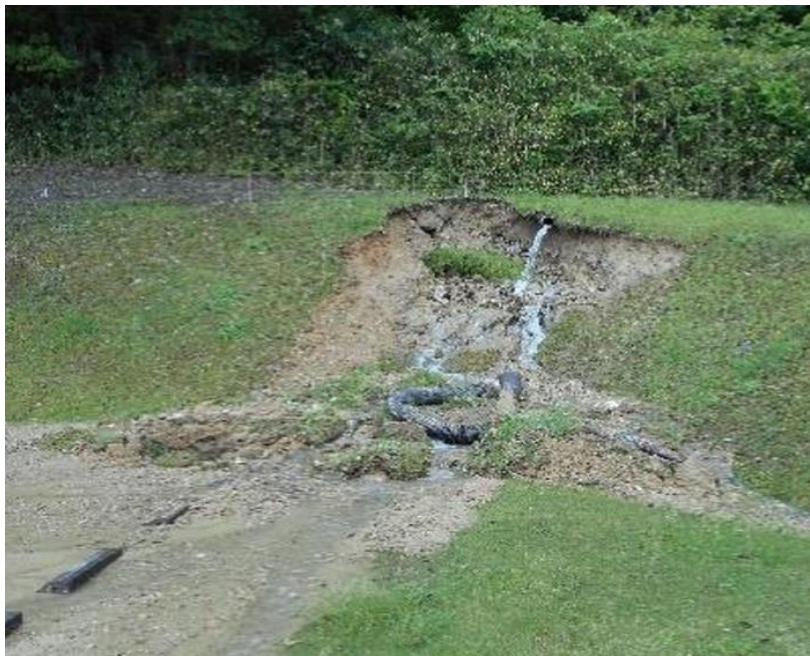
令和5年5月 大雨による土砂崩れ発生。
